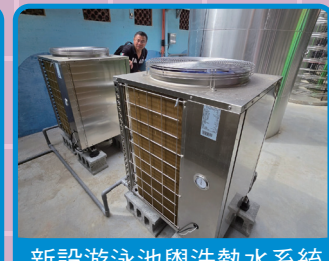
新設游泳池盥洗熱水系統
